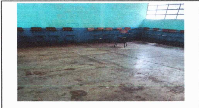
remozar el techo de la escuela es necesario debido a que se encuentran agujeros los cuales ocasionan filtraciones de agua pluvial, lo cual se nota en las manchas de humedad en el piso
