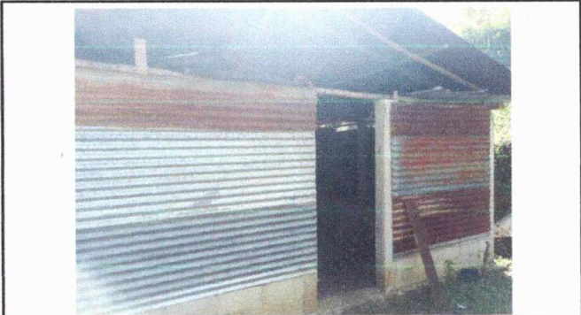
actualmente el ambiente no cuenta con puerta de acceso lo que es fundamental para resguardar los alimentos y asi darle seguridad
