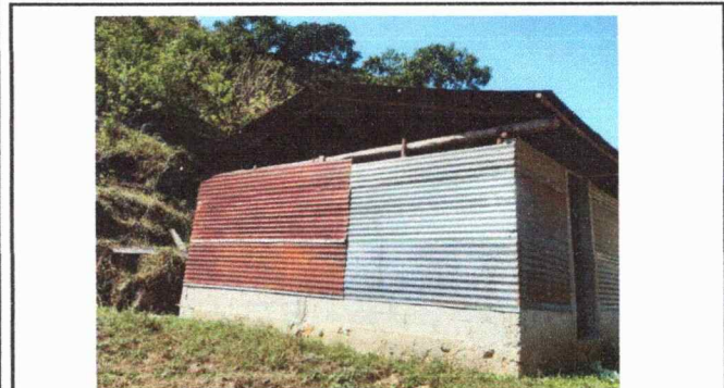
en la fotografia se observa que no es un ambiente seguro debido a que no cuenta con paredes solidas las cuales son necesarias por cualquier eventualidad meteorologica.
