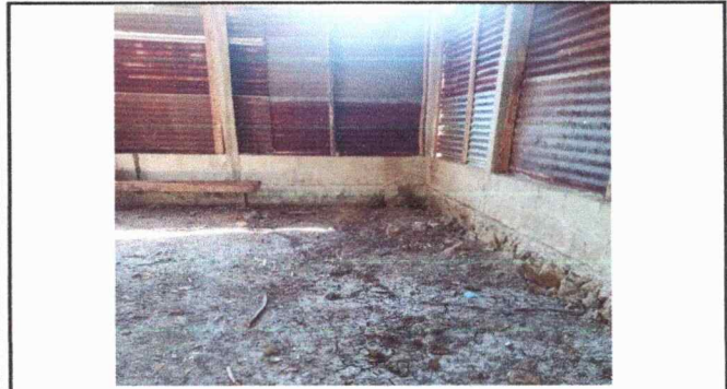
se observa la pesima condicion del espacio de cocina, donde se concionan los alimentos a los niños, se busca mejorar el ambiente y asi darle un ornato idoneo
